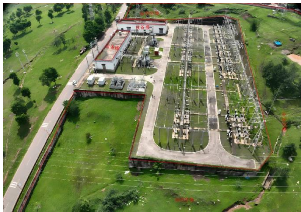
拉木阿觉变电站现状
